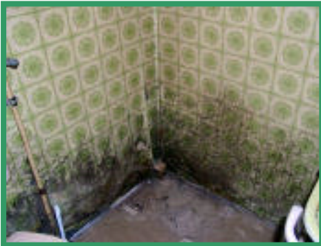
Schimmelpilzbefall im Bad
